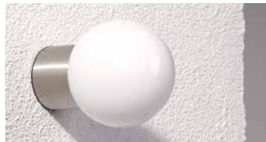
Bild 24: Befestigung einer Außenleuchte mit Hilfe von Mini-Geräteträgern
