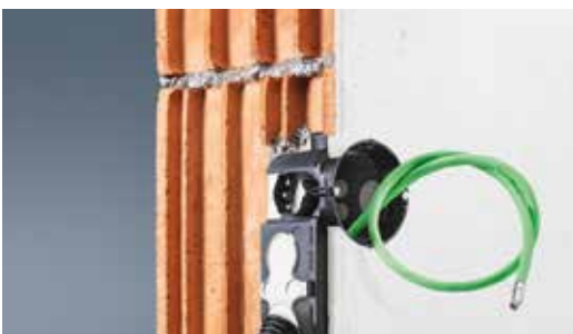
Bild 9: Elektronik- und Doppeldosen in luftdichter Ausführung zur Einhaltung der Biegeradien von Netzwerkleitungen
