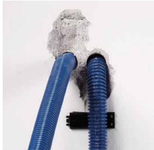
Bild 20: Elektroinstallationsrohre mit Schienenbefestigung (Klicksystem)
